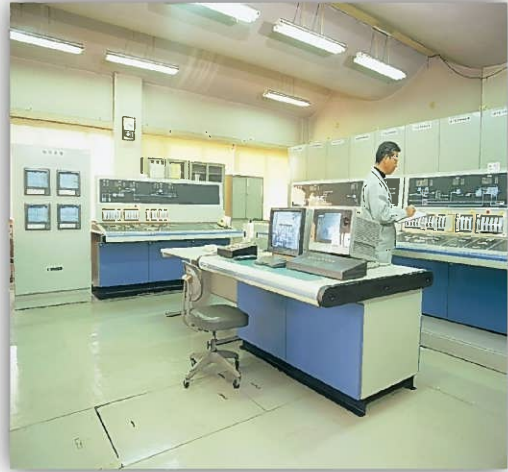
上野浄水場の監視室
