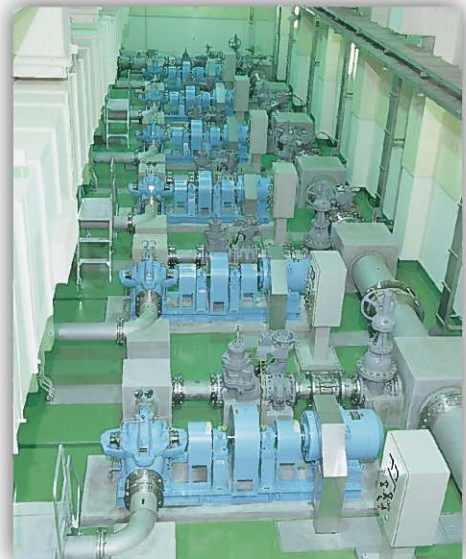
西部水源地の送水ポンプ(平成13年設置)
