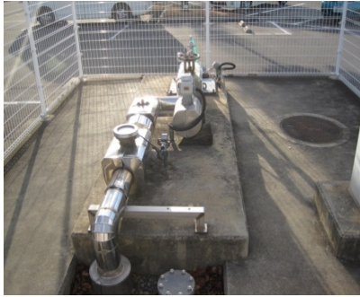
地下水ポンプ
