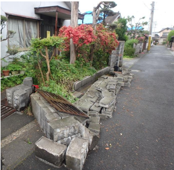
熊本地震によるブロック塀の倒壊
