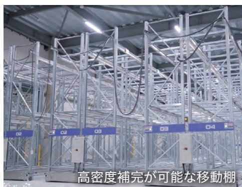
パレット自動倉庫システム
