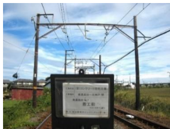
木製電柱(劣化)
