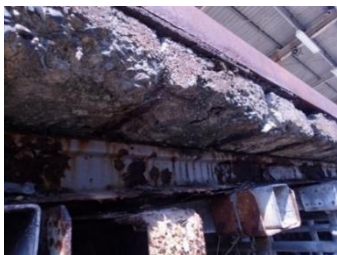
駅ホーム下(劣化)
