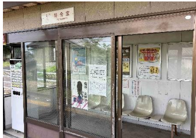
駅待合室(劣化)
