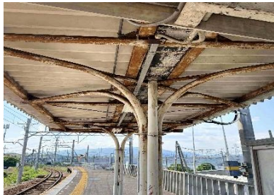
駅ホーム屋根(劣化)
