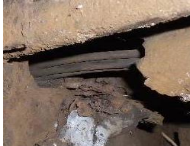
車両下部(電線管腐食)
