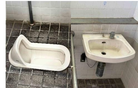
駅トイレ和式便器・洗面台(劣化)
