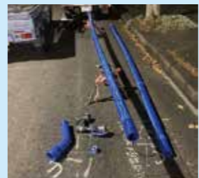
耐震性のある配水管
