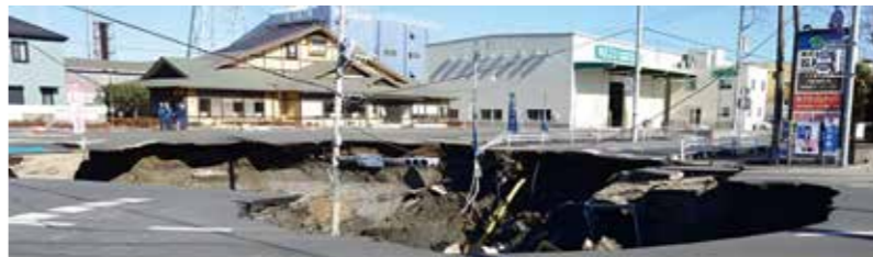
埼玉県八潮市の事故の様子(埼玉県ホームページより引用)
