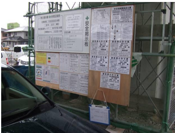
安全掲示板状況
