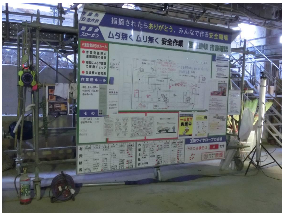
写真4：地下室に設けられた朝礼広場の掲示の状況
