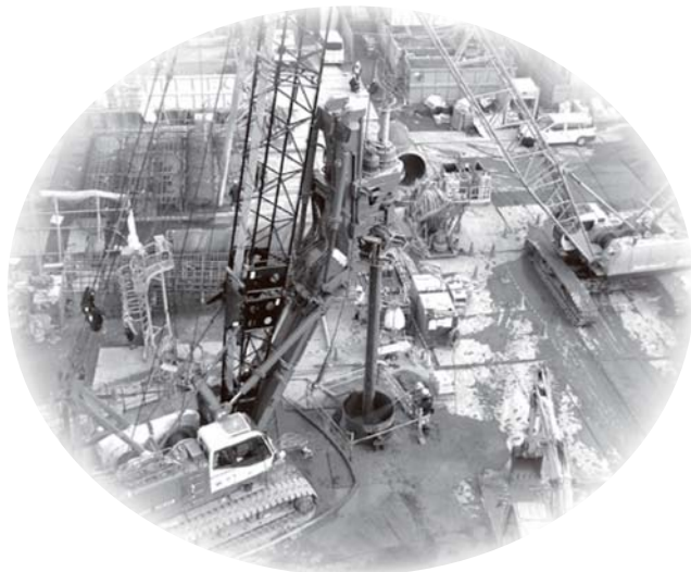
桑名市総合医療センター建設工事が10月10日から始まりました
