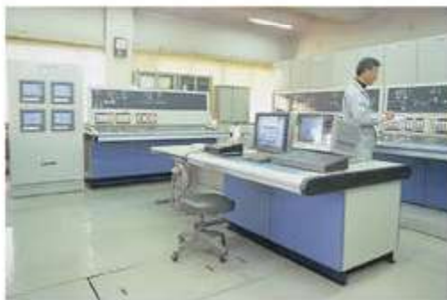
しゅうちゅうかん ししつ 集中監視室
