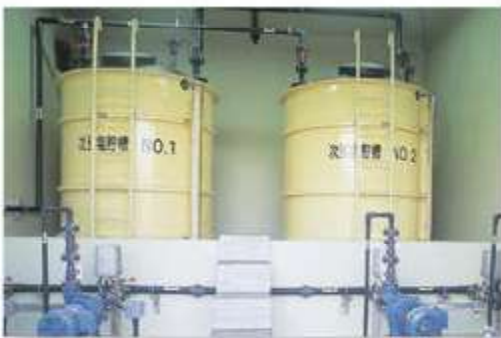
えん そ ちゆうにゆうせつ び 塩素注入設備
