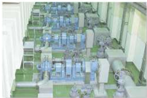
そうすい しつ 送水ポンプ室
