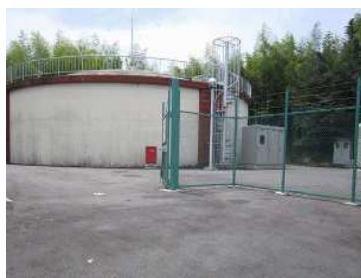
多度北部配水場
